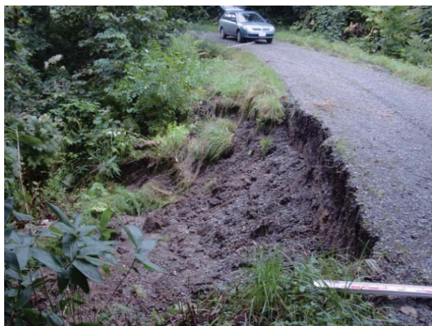
8月25日の豪雨による被害 (町道兵安松音知線の路肩崩壊)
