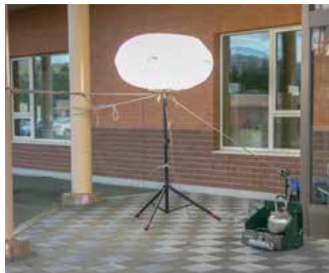
→ 役場正面玄関光源設備
