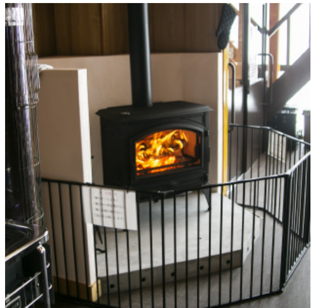
新設の薪ストーブ
