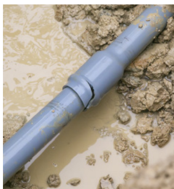
◇破損した水道管
