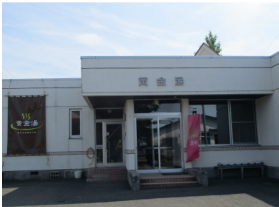
設備の老朽化により今後の稼働が困難になっている黄金湯
